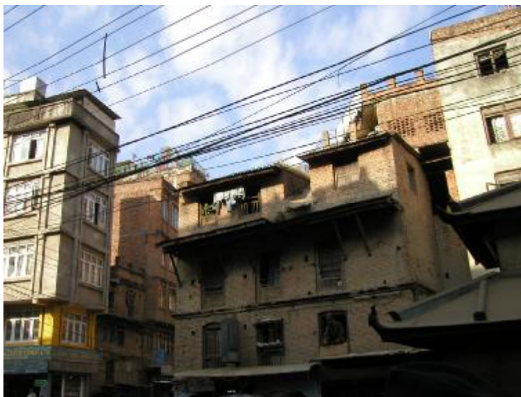
شکل (21-2): نمونه ای از ساختمانهای قدیمی و آسیب پذیر در شهر کاتماندو
